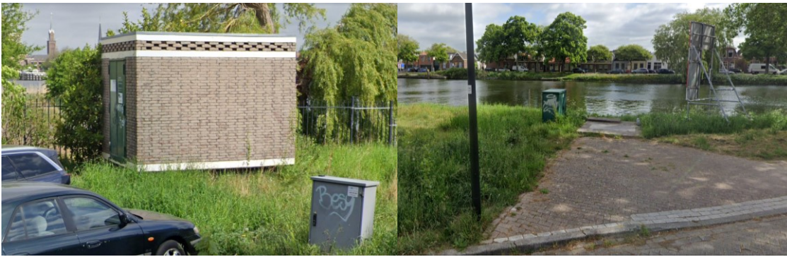
Figuur 7: Aanwezige trafo en elektriciteitskast aan de zuidoost kant van het plangebied.
