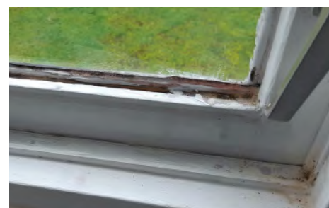
Kitwerk kozijn ontbreekt
