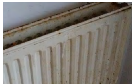
Niet schoon/ roestvorming
