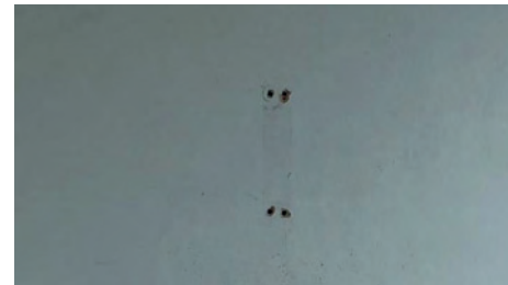
Gaten in de muur
