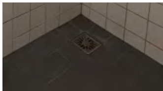
Kalkaanslag op de vloer
