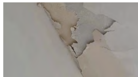
Stucwerk laat los
