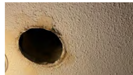
Gaten in het plafond
