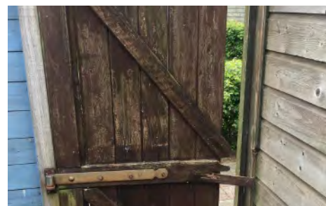
Kapotte schutting. Deze wordt eventueel vervangen door piketpaaltjes.
